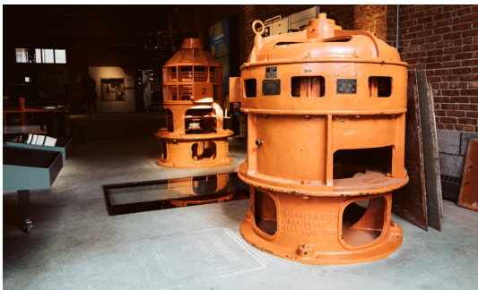
Salle des moteurs, Station de pompage D'Youville, Anonyme Bergson, © Pointe-à-Callière, Cité d'archéologie et d'histoire de Montréal.
